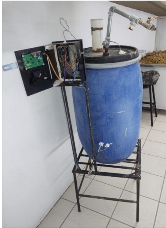
Figura 3. Vista del biodigestor con el sistema embebido integrado.
