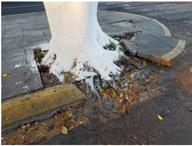
Figura 3. Elaboración propia (2021). Evidencia de daños en guarnición y pavimento.
