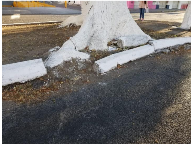
Figura 4. Elaboración propia (2021). Evidencia de daños en guarnición.
