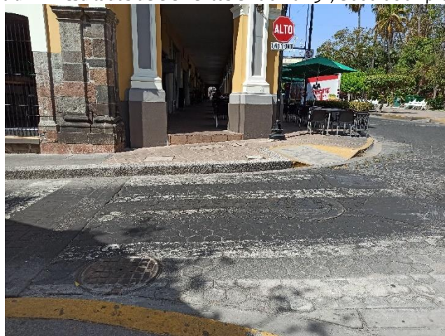
Figura 6. “Cruce peatonal deficiente en tramo 06”, fotografía tomada por la autora.
