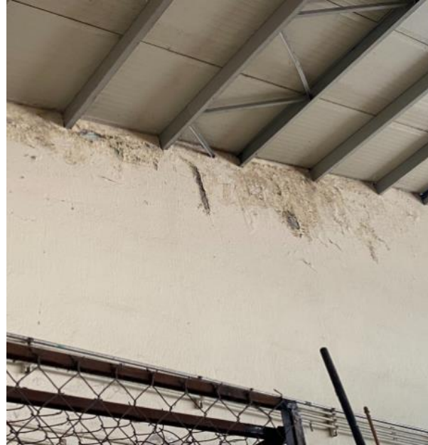
Figura 12. Lesiones físicas y mecánicas en paredes. Fuente: elaboración propia, 2022.
