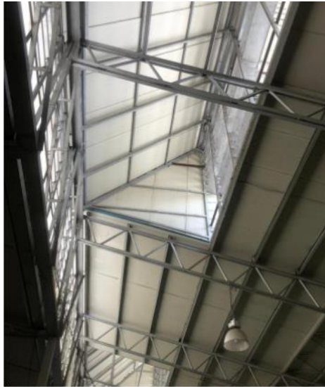
Figura 15. Lesiones físicas y mecánicas en armadura de acero. Fuente: elaboración propia, 2022.
