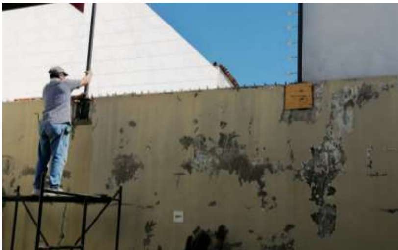
Figura 2. Presencia de salitre en Residencial construida hace 16 años. Por: Maya P.N. (2021) Real Vista Hermosa, Colima
